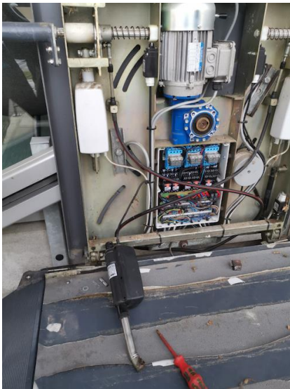
Das Innenleben des Behindertenlifts
